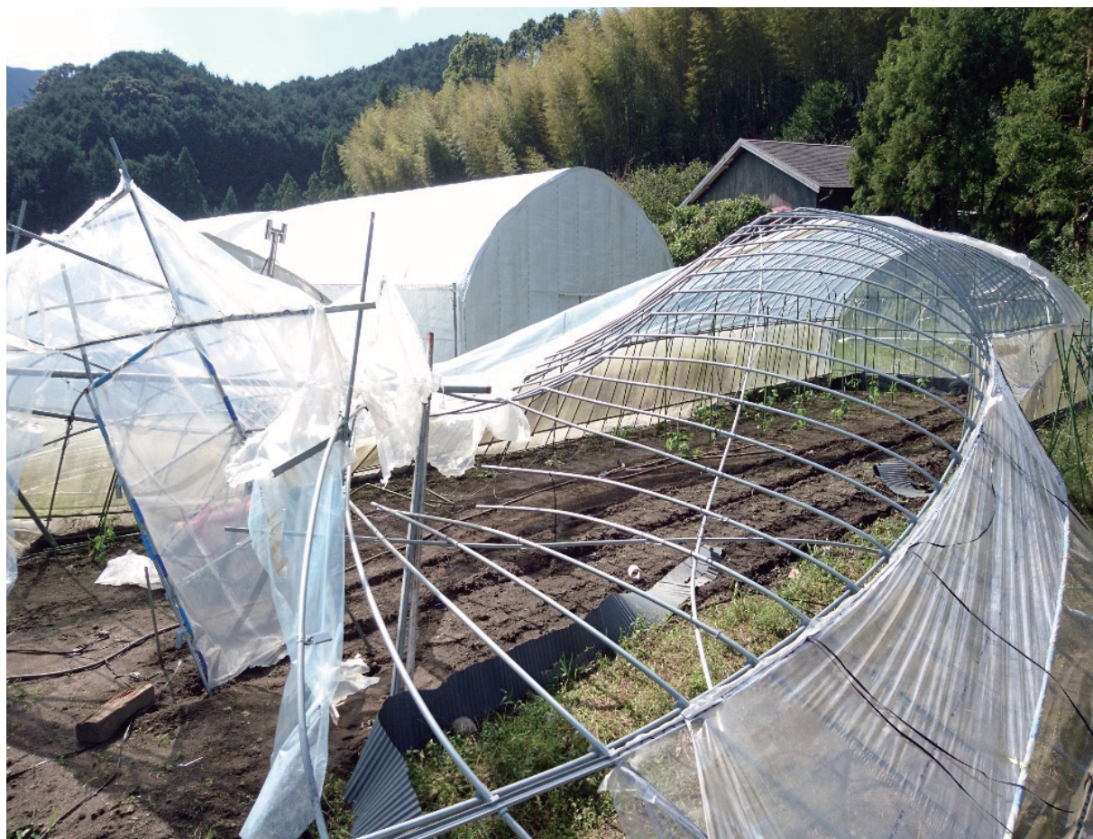
強風で被害にあったビニールハウス
